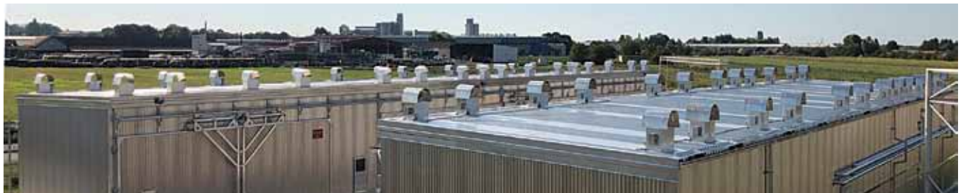
Kompleks konvencionalnih sušara u sklopu kogeneracijskog postrojenja
