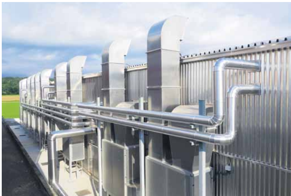
Sušara za drvo, rekuperatorski sistem i toplovodna instalacija
