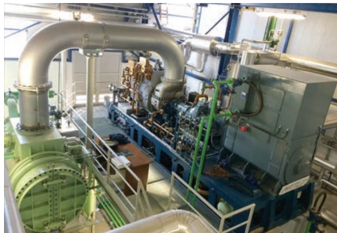
Parna turbina sa generatorom i vodenim kondenzatorom
