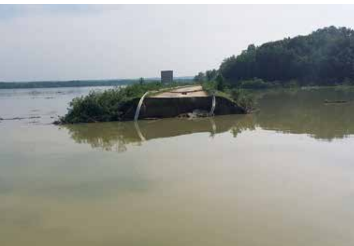
Podvrska reka je uništila most na ušću u Dunav
