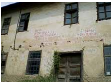
Na velikom broju popisanih stambenih zgrada više nije potrebna zamena fasadne stolarije
