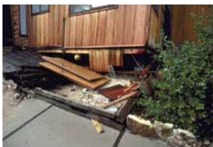
Slabo mesto u konstrukciji - neadekvatno ankerovanje za temelje
