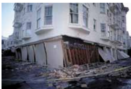
Oštećenje drvenih kuća usled seizmićkog dejstva slabo mesto u konstrukciji - meko prizemlje
