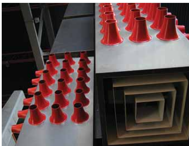
Detalji instalacija na tavanici zgrade Sava Centra
